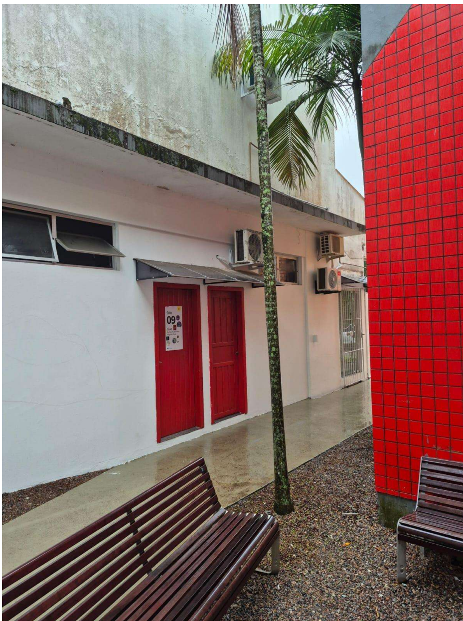
Corredor CA Artes Cênicas (aqui se vê como a parte superior necessita de reforma, projeto em andamento sgpe 44958/2025)
